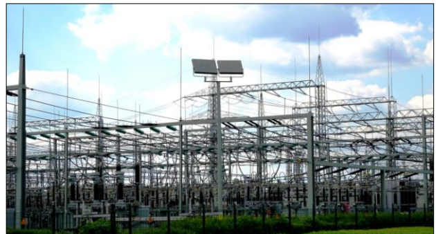
Umspannwerk bei Sechtem (Foto: M. Pacyna)
